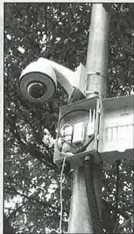
侵入検知カメラ
